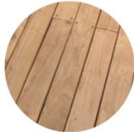
Platelage bois (Passages des noues paysagères)
